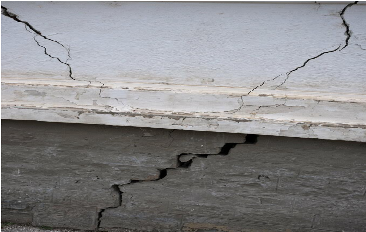
(شكل 7) هبوط المبنى نتيجة عدم تحملا، التربة للمبنى.
