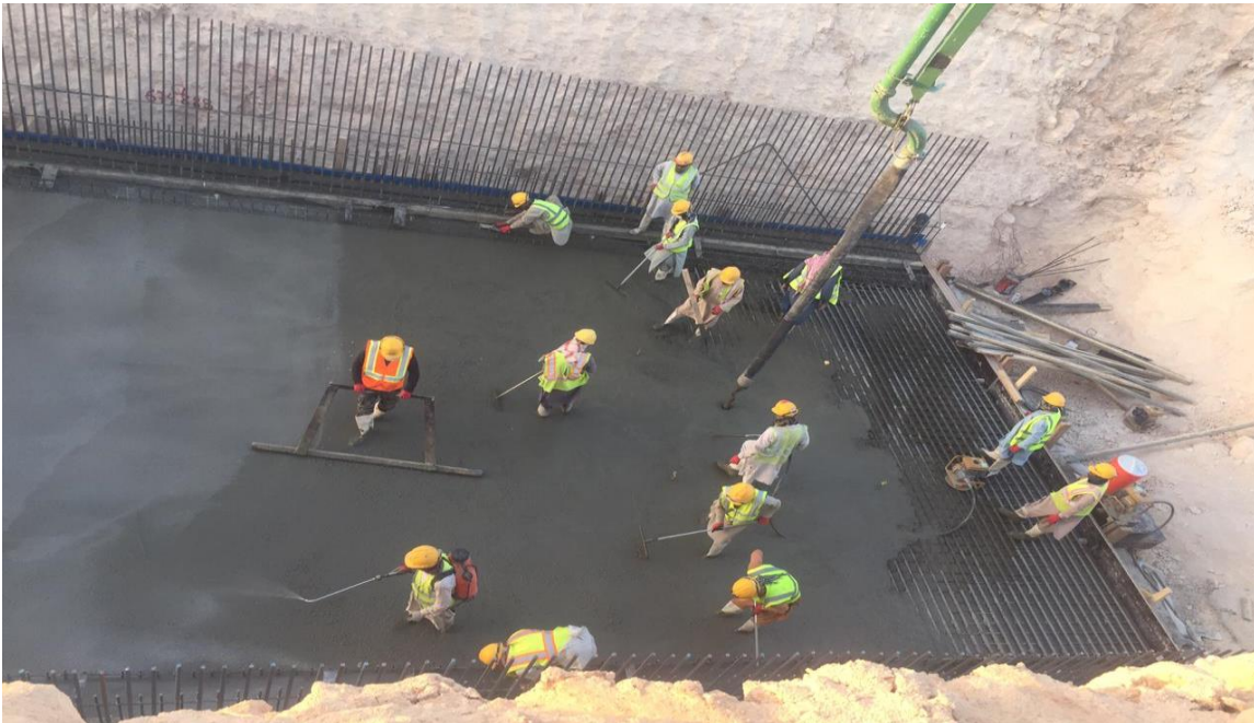
(شكل رقم 27) يوضح قرب خرطوم المضخة من مكان الصب حتى لا تنفصل مكونات الخرسانة بعضها عن بعض
