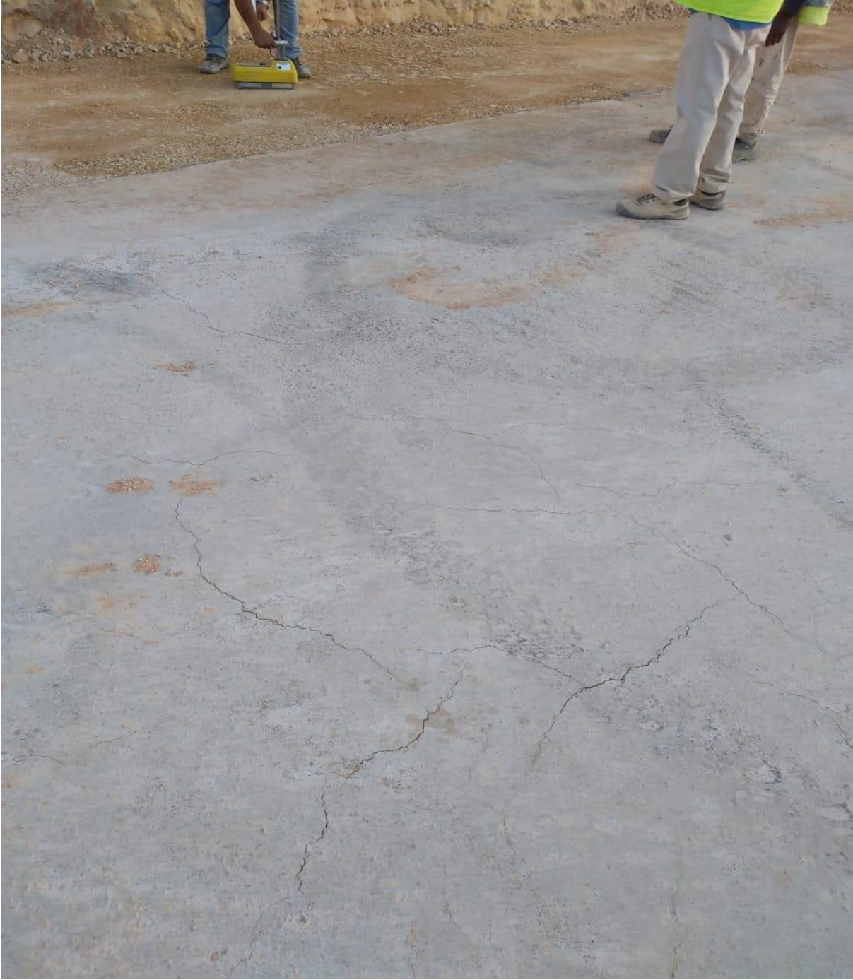
(شكل رقم 30) يلاحظ تشققات سطحية او شعيرية (Hair cracks) على سطح الخرسانة
